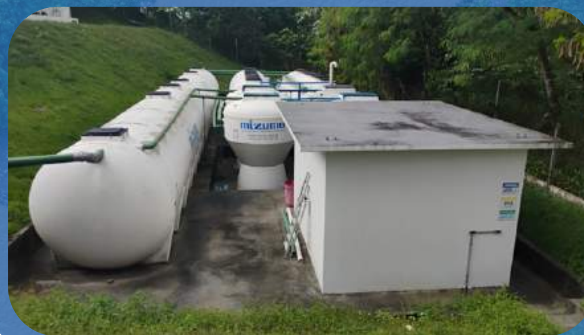
Figuras 9 e 10 – Estação de tratamento de efluentes mantida pela Flex, 2025
